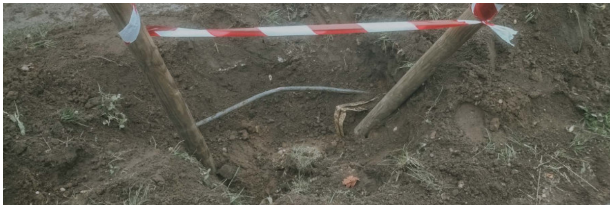
27. fotó: A közvilágítás kábel sérülése faültetése során
