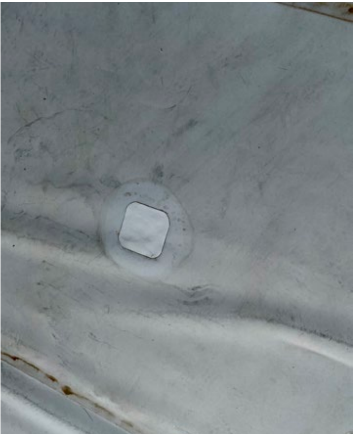
107. kép Javított pontszerű mechanikai sérülés csapadékvíz-szigetelésen. Fotó: Dezsényi Péter
