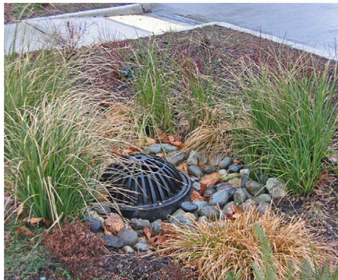
36. fotó Túlfolyó kialakítása
