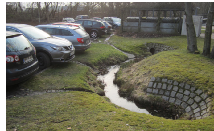
60. fotó Parkolófelület csapadékvizének gyűjtése
