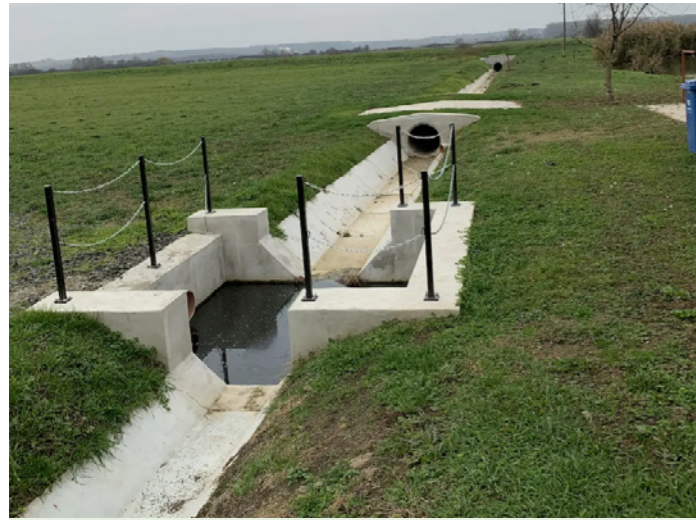
23. fotó Hordalékfogó műtárgy
