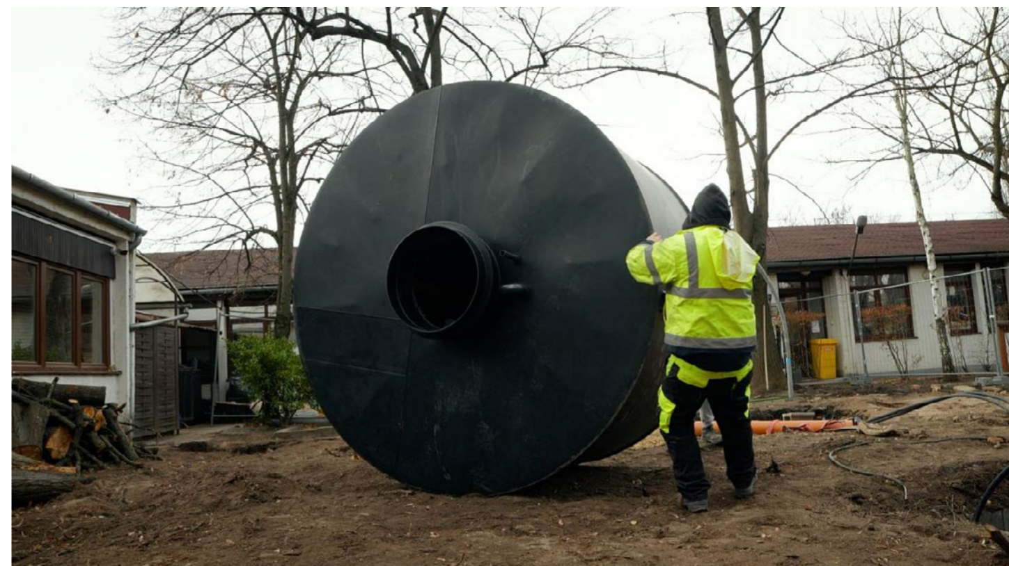
2. ábra: A Zuglói Hétszínvirág Óvoda udvarán beépített tartály (forrás: OPPLA URL8 )
