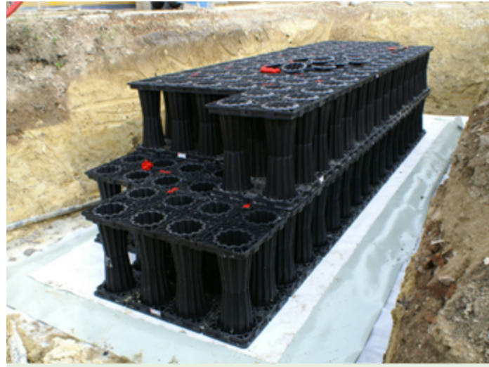
40. fotó Szikkasztóládás csapadékvíz szikkasztás
