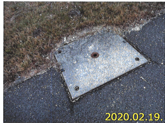
Közműalagút fedél a járdán
