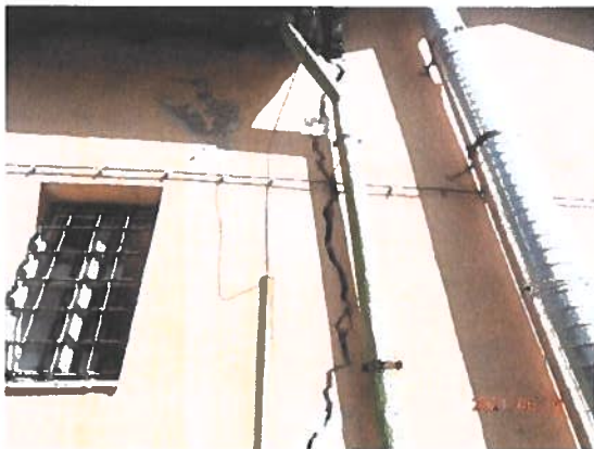
Nyugati homlokzaton repedés
