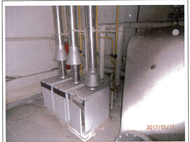
Kazánház (gázkazánok és forróvítároló)
