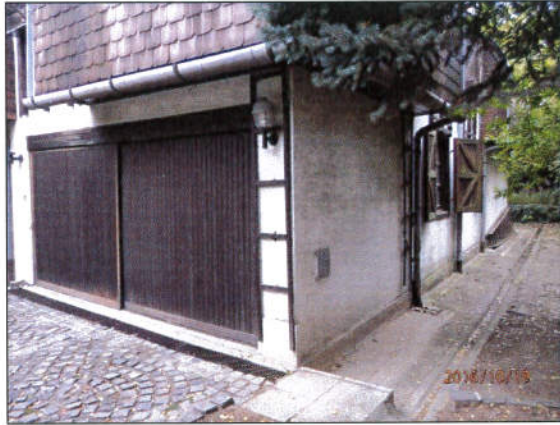
A ráépített épület telekre átlógó része
