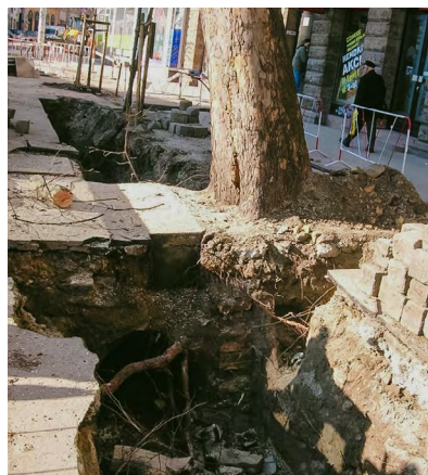
8. fotó: Gyökérsérülés építési munka miatt
