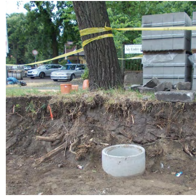
9. fotó: Gyökérsérülés építési munka miatt
